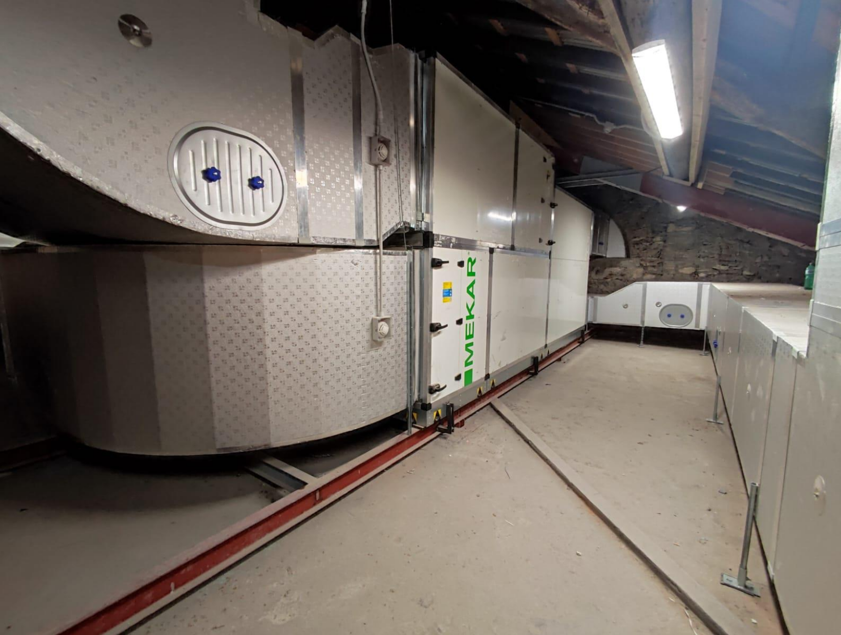
Teatro della Società – unità trasformazione aria (UTA)
